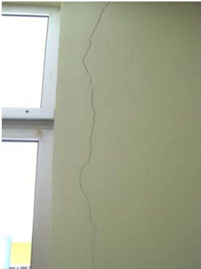
1, Fissura existente em alvenaria no Recreio Coberto
