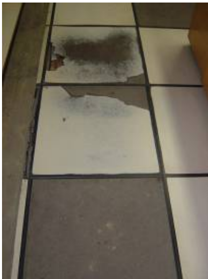
Figura 189: Piso em péssimo estado de conservação.
