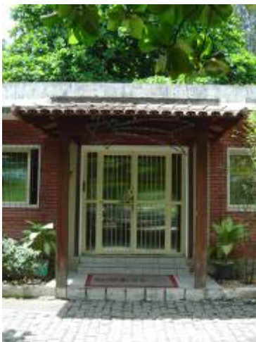
Figura 195: Degraus impedindo a acessibilidade total.
