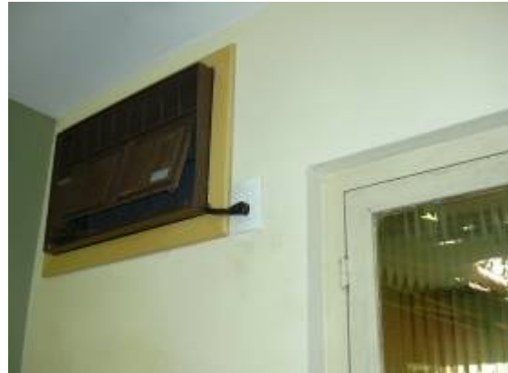
Figura 194: Ar condicionado, outra fonte de ruído.
