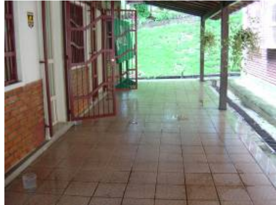
Figura 186: O acesso às salas fica molhado devido a falta de drenagem do ar condicionado.
