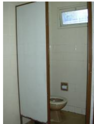
Figura 196: Sanitários não adaptados.
